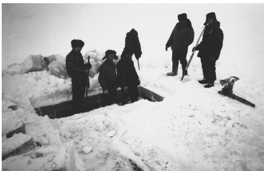
Рис. 12.6. Изготовление 10-метровой направляющей нефтеулавливающей прорези на р. Оби у с. Локосово, март 1999 г. (вид по течению)
