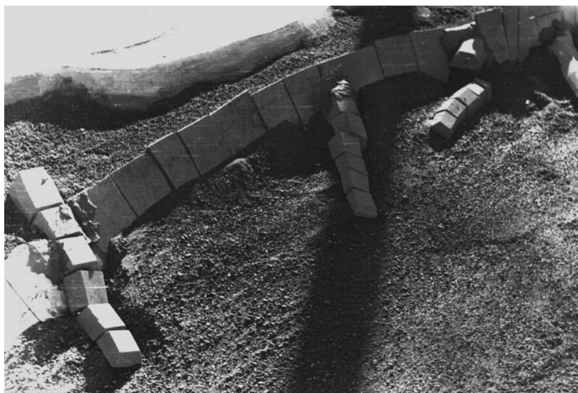
Рис. 10.15. Разрушение ныряющих шпор выше водозабора после прохождения паводка 0,33 %-ной обеспеченности
