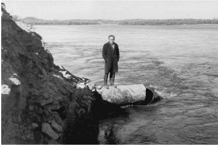
Рис. 8.13. Глубинный рассеивающий выпуск, разрушенный паводком 1973 г. (вид по течению)
