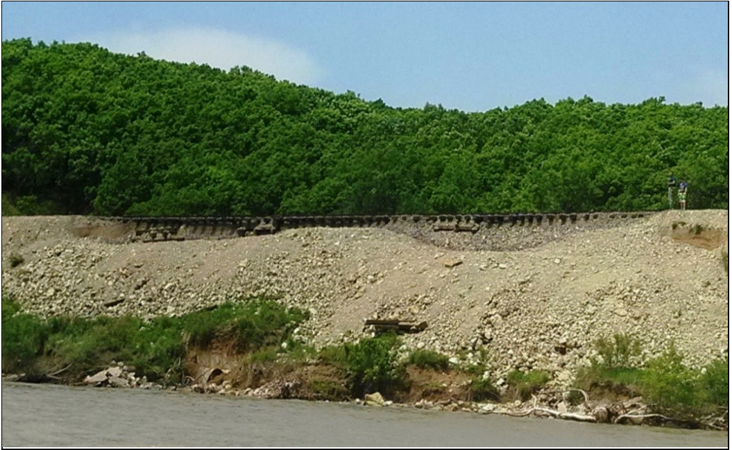
Рисунок 2.5 – Часть смытой железнодорожной насыпи на побережье озера, между Новокачалинском и Платоно-Александровским
