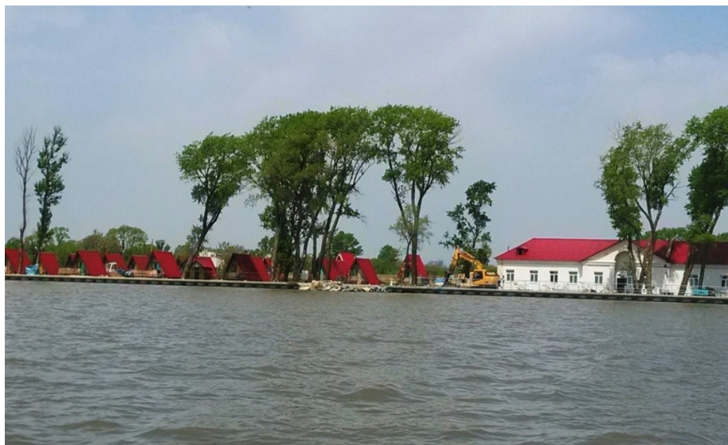
Рисунок 2.3 – Разрушенный пирс базы отдыха в с. Новокачалинск
